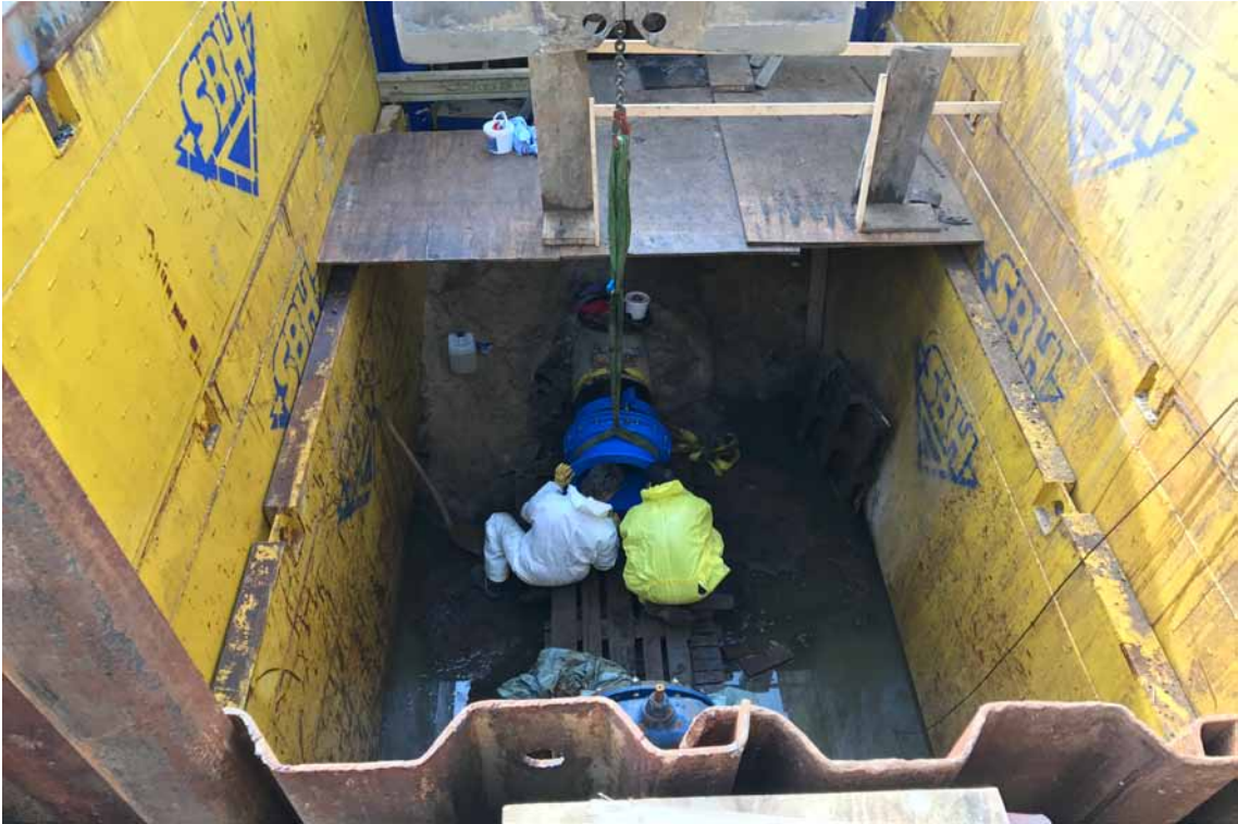
Montage eines Spezialflansches, durch den der BlueLiner in die zu sanierende Leitung eingebracht wurde.
