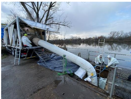
BU: Installation unter erschwerten Bedingungen: Die Inversionstrommel stand im 90° -Winkel zur Sanierungsstrasse
